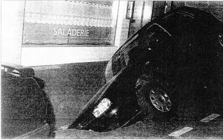
Encore un trou indésirable ! Le creusement du métro a provoqué, samedi matin, un troisième affaissement
